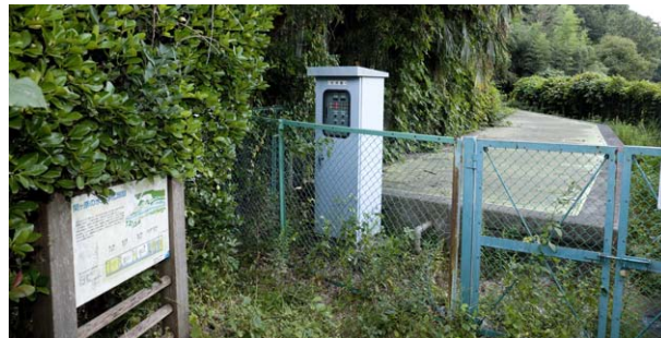
河川敷の緑のなかに設置されている水質浄化施設
