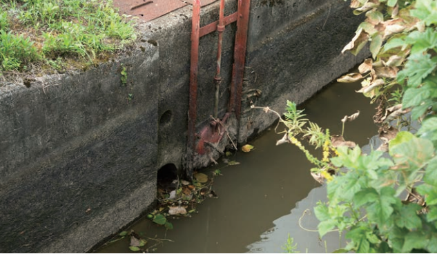
別所川頭首工のそばで見つけた「ガニ穴」。しっかりコンクリートで固められている。水位が下がるとこうした小さな穴があちらこちらに現れるという
