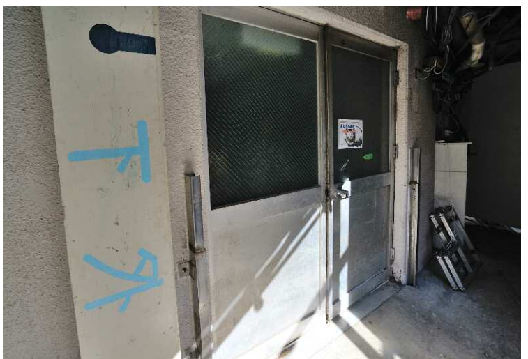
下：餌の準備をする厨房室への入口。津波に備えて入口に堰板をはめて防水する仕組みが備えられていたが、3・11ではこの高さを乗り越えて水が入ってしまった。
